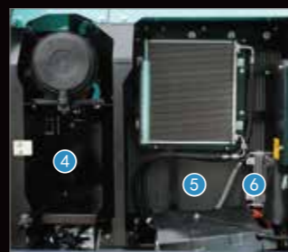
左侧舱室 散热器和冷却系统，触手可及。 ④ 工具箱 ⑤ 带有防虫网的散热器 ⑥ 柴油冷却器
